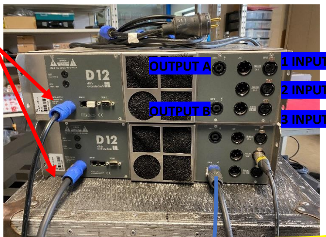
Figure 85/ Face arrière de deux Ampli D12
